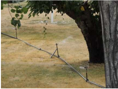
.. I310 Sprinkler - Handline
