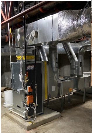
KVR new fan coil
